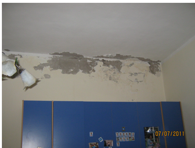
Foto n.14 – Fenomeni di infiltrazioni e umidità presenti all'interno della camera 1
