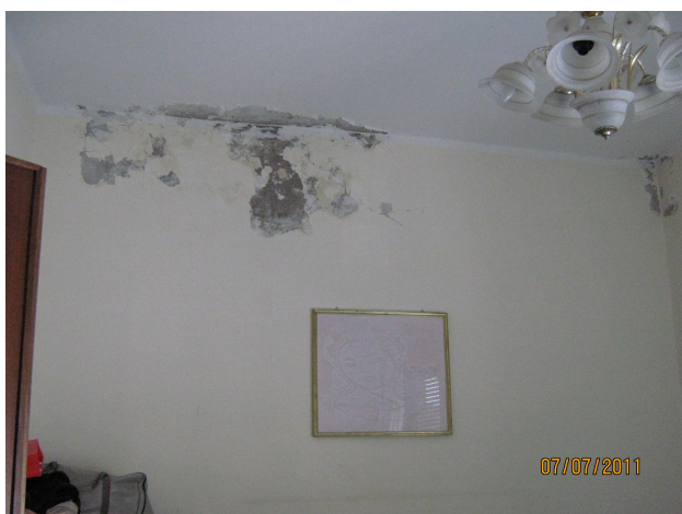
Foto n.18 – Fenomeni di infiltrazioni e umidità presenti all'interno della camera 2
