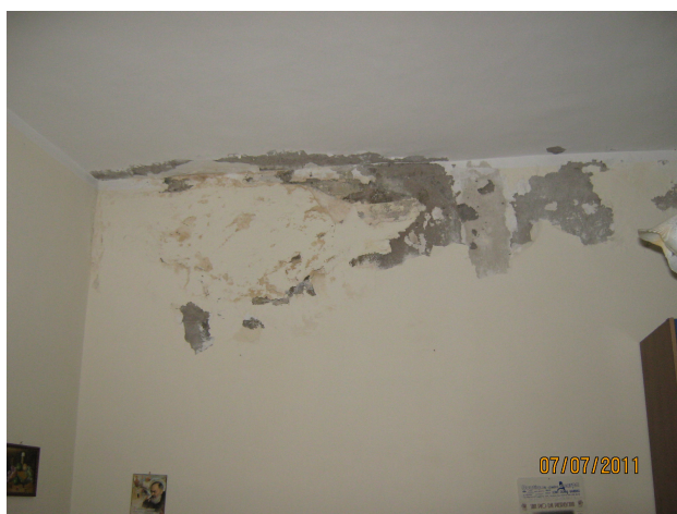
Foto n.15 – Ulteriori fenomeni di infiltrazioni e umidità presenti all'interno della camera 1
