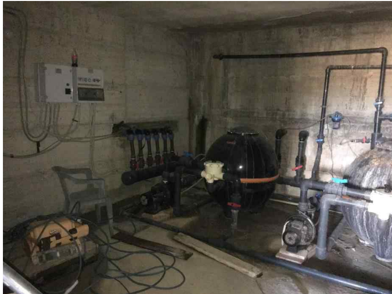
Foto 104 - Piano seminterrato, locale tecnico
