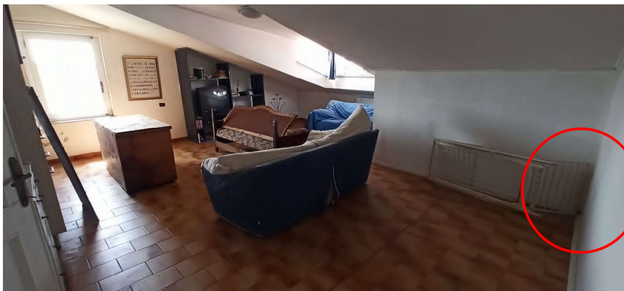
Figura 33 - Piano sottotetto – Locale di sgombero 2 e parete di separazione realizzata in difformità dal progetto di sanatoria
