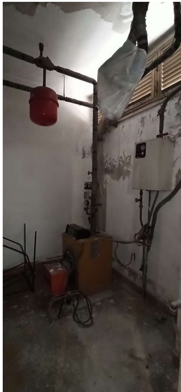
Figura 45 - Piano seminterrato - Centrale termica
