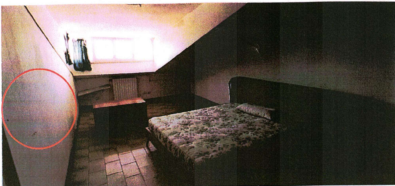
Figura 35 - Piano sottotetto – Locale di sgombero 3 e parete di separazione realizzata in difformità dal progetto di sanatoria
