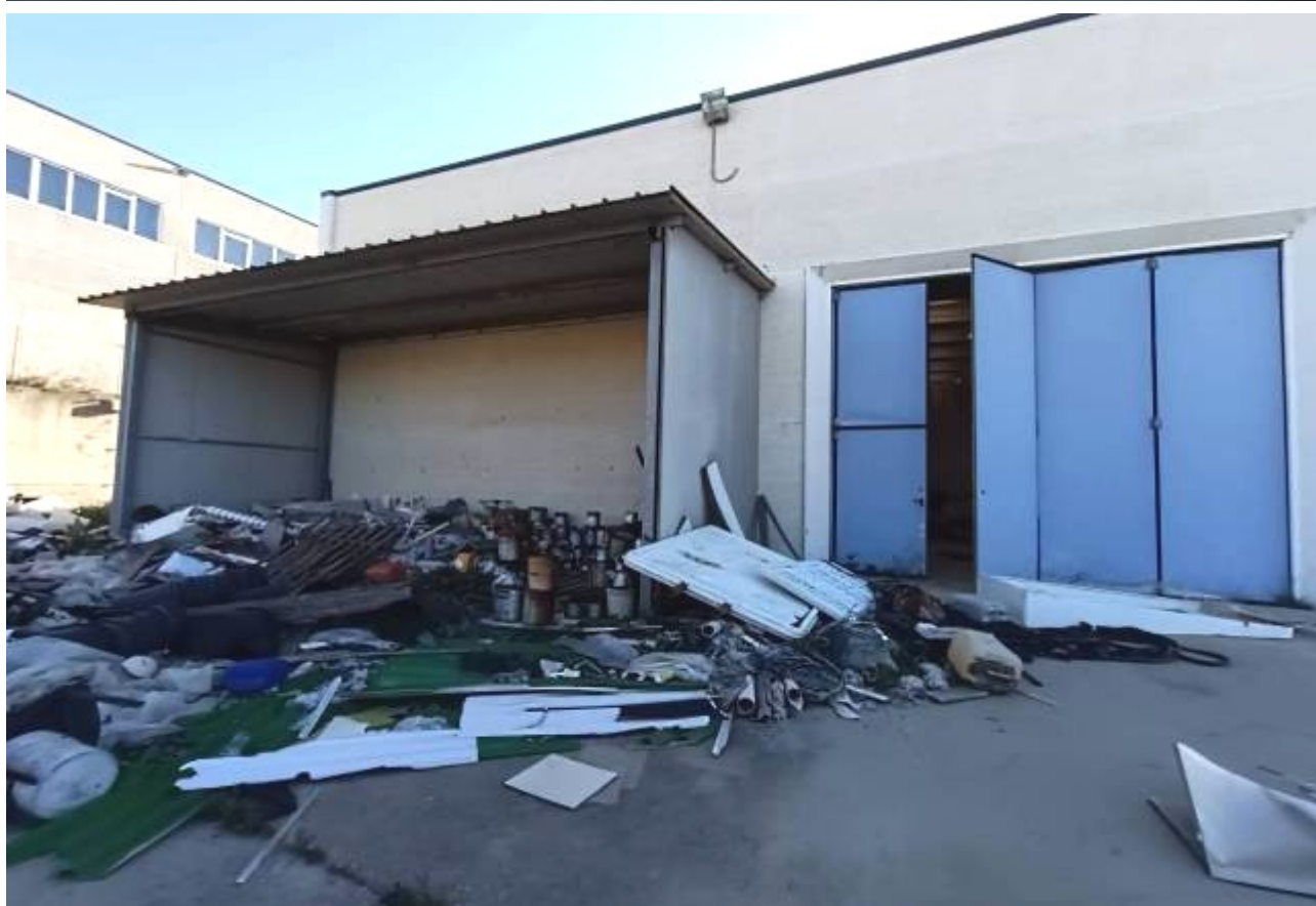
Figg.11-12 Via A. Molinari (già Via Vigne Turci) Civitavecchia (RM) Fg. 13 P.lla 640 - Il fabbricato industriale e l'area esterna pertinenziale - prospetto laterale NordOvest con tettoia \approx 9 \times 5 m priva di titolo
