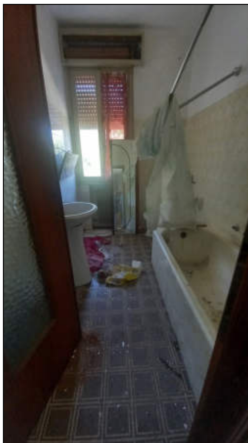
Foto 45: Appartamento (P.2° sub. 7) – Interno con evidenti segni di degrado
