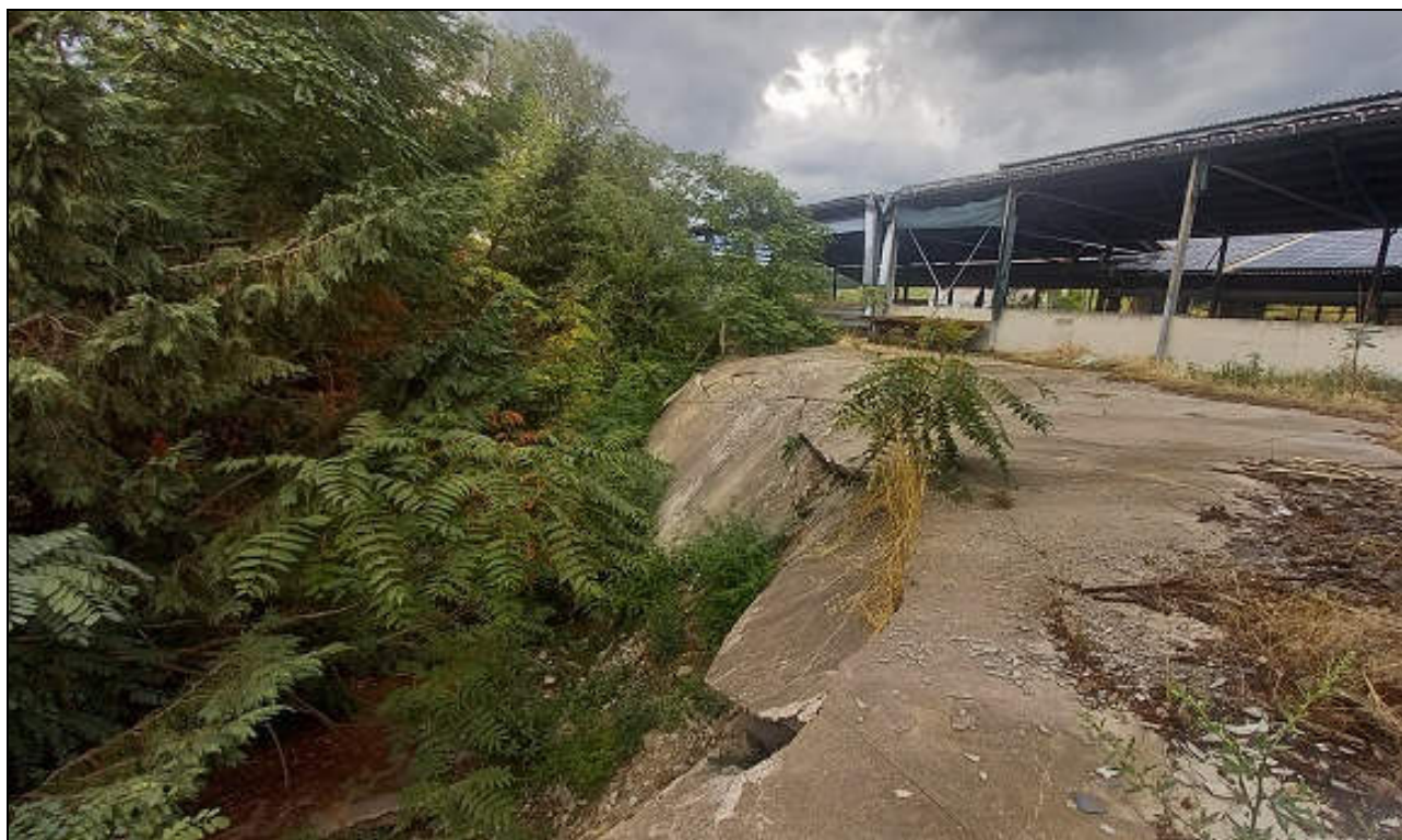
Foto 33: porzione dell'area cortiliva con cedimenti strutturali e degradi del battuto di cemento
