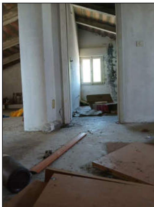
Foto 48: Appartamento - Sottotetto difforme
