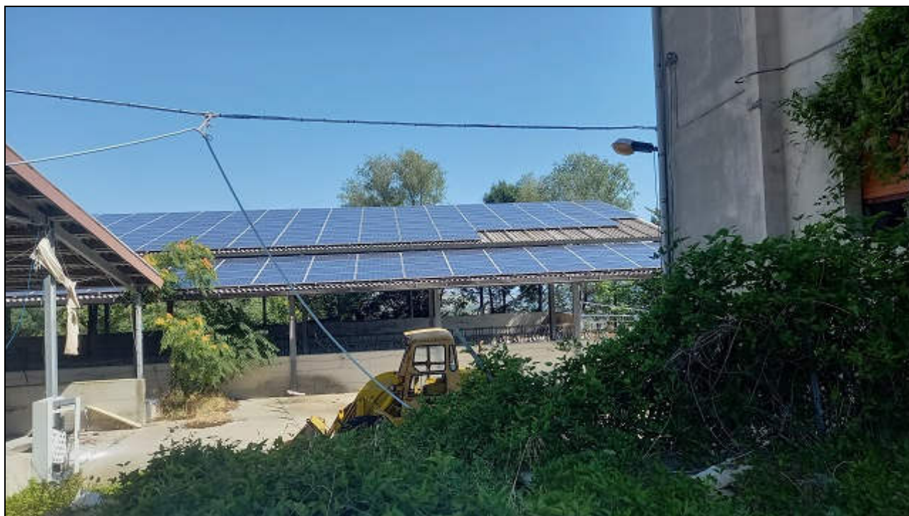
Foto 52: Vista dell'Impianto fotovoltaico (P.1°), particella 221 parte sub 11
