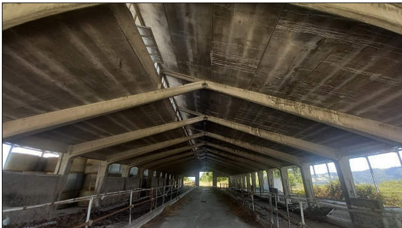
Foto 9: Stalla – Interno, porzione centrale in c.a. con evidenza dello stato manutentivo carente
