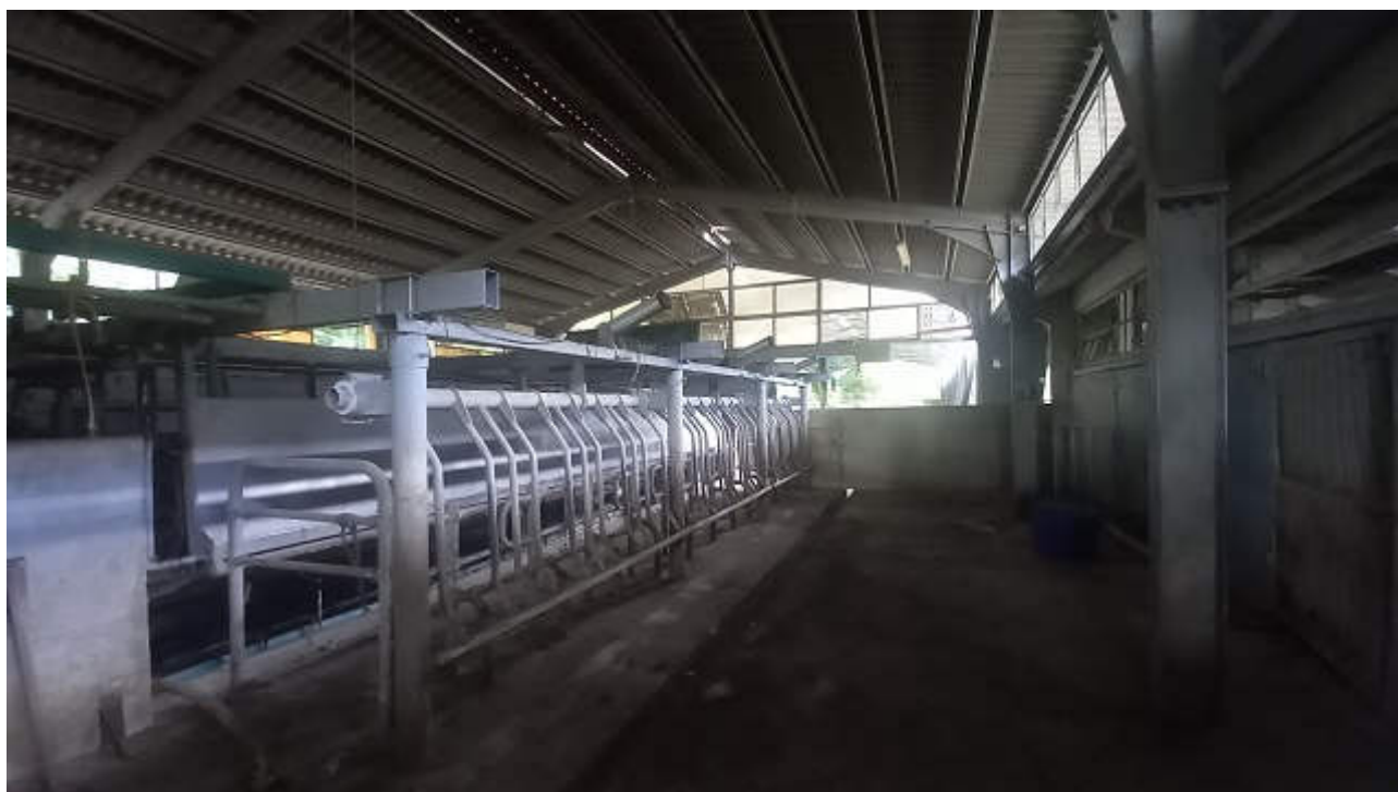
Foto 24: Stalla, porzione laterale metallica – Interno con evidenza dello stato manutentivo carente
