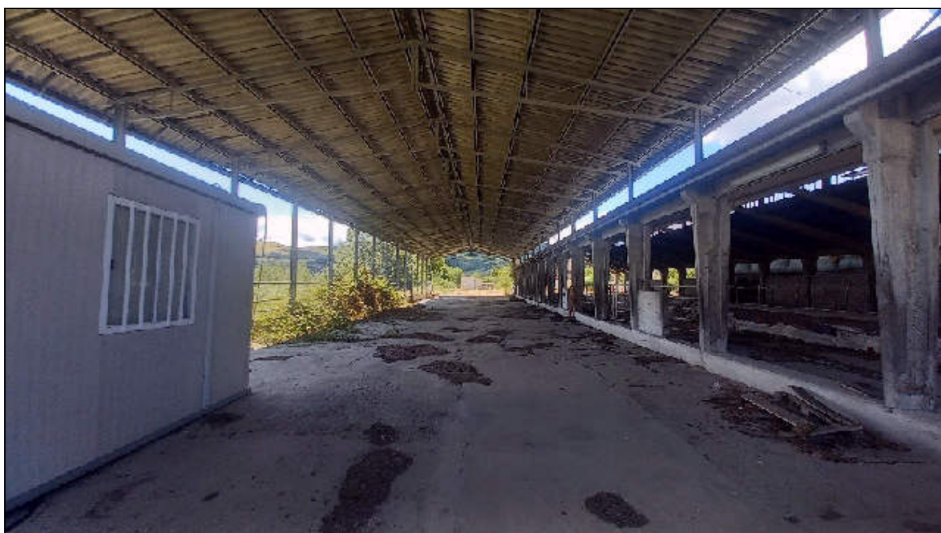
Foto 10: Stalla – Interno, porzione laterale metallica con evidenza dello stato manutentivo carente
