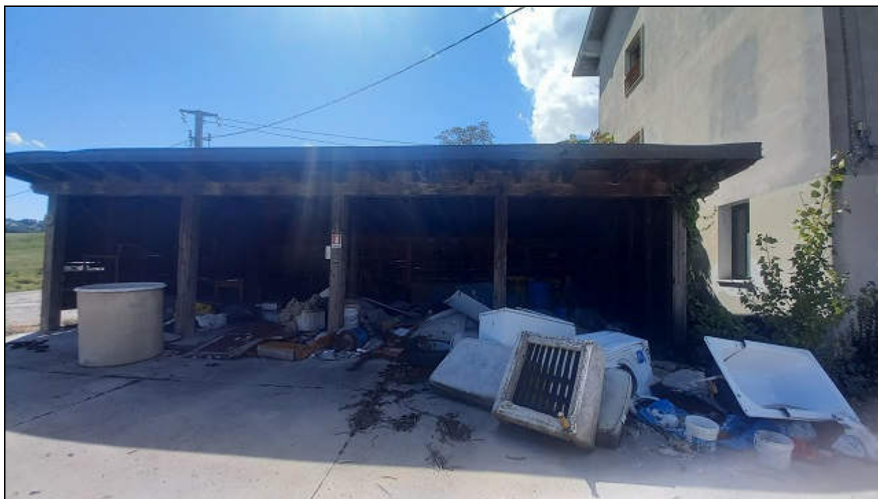
Foto 51: Posto auto (P.T. sub. 5) con evidente stato di degrado
