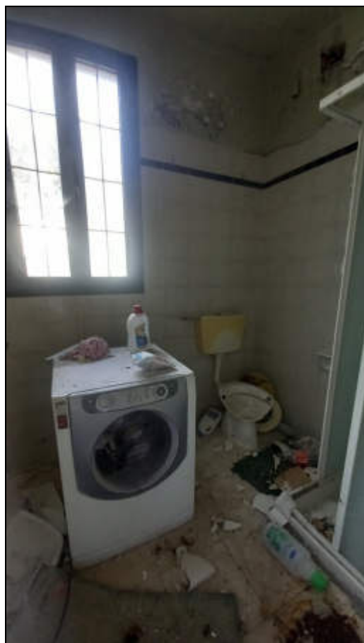
Foto 50: Uffici (P.T. parte sub. 10) – Interno con evidente stato di degrado
