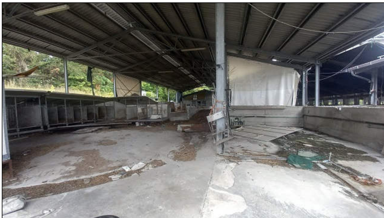
Foto 22: Stalla, porzione laterale metallica – Interno con evidenza dello stato manutentivo carente
