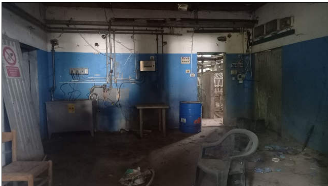
Foto 23: Stalla, porzione laterale metallica – Interno con evidenza dello stato manutentivo carente
