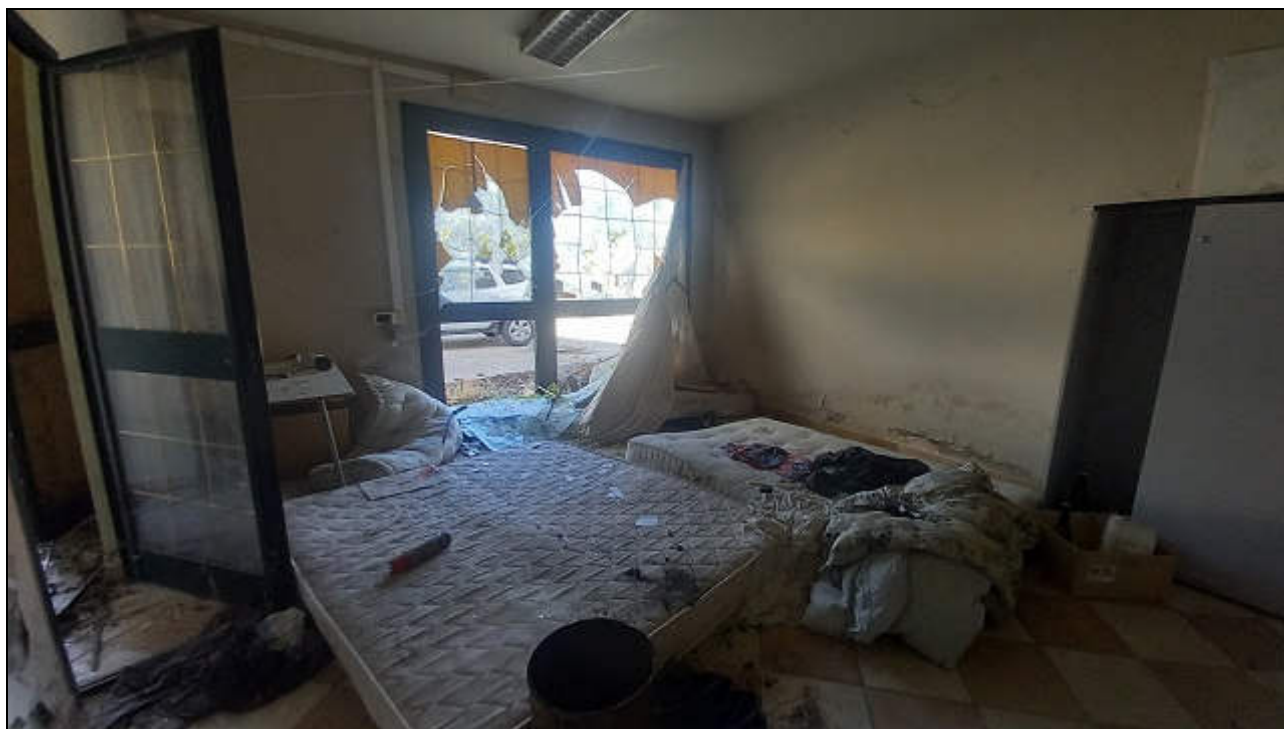
Foto 49: Uffici (P.T. parte sub. 10) – Interno con evidente stato di degrado
