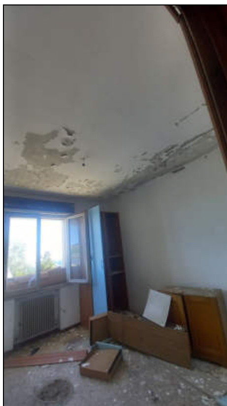
Foto 46: Appartamento (P.2° sub. 7) – Interno con evidenti segni di degrado
