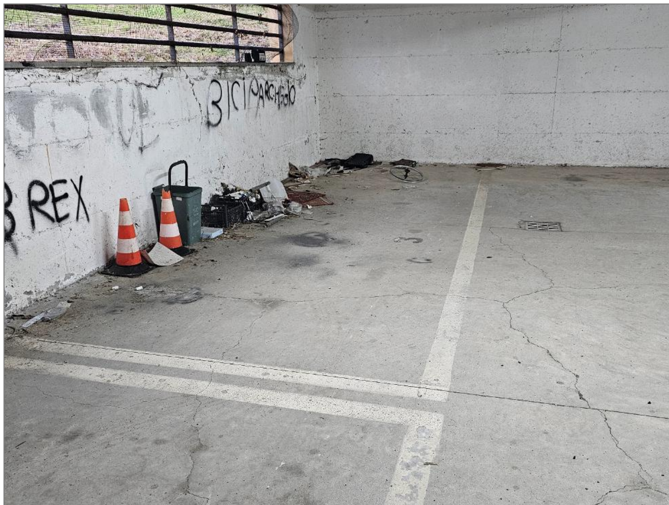
Foto 29, 30 –Posto auto al piano secondo seminterrato contraddistinto dal numero 3
