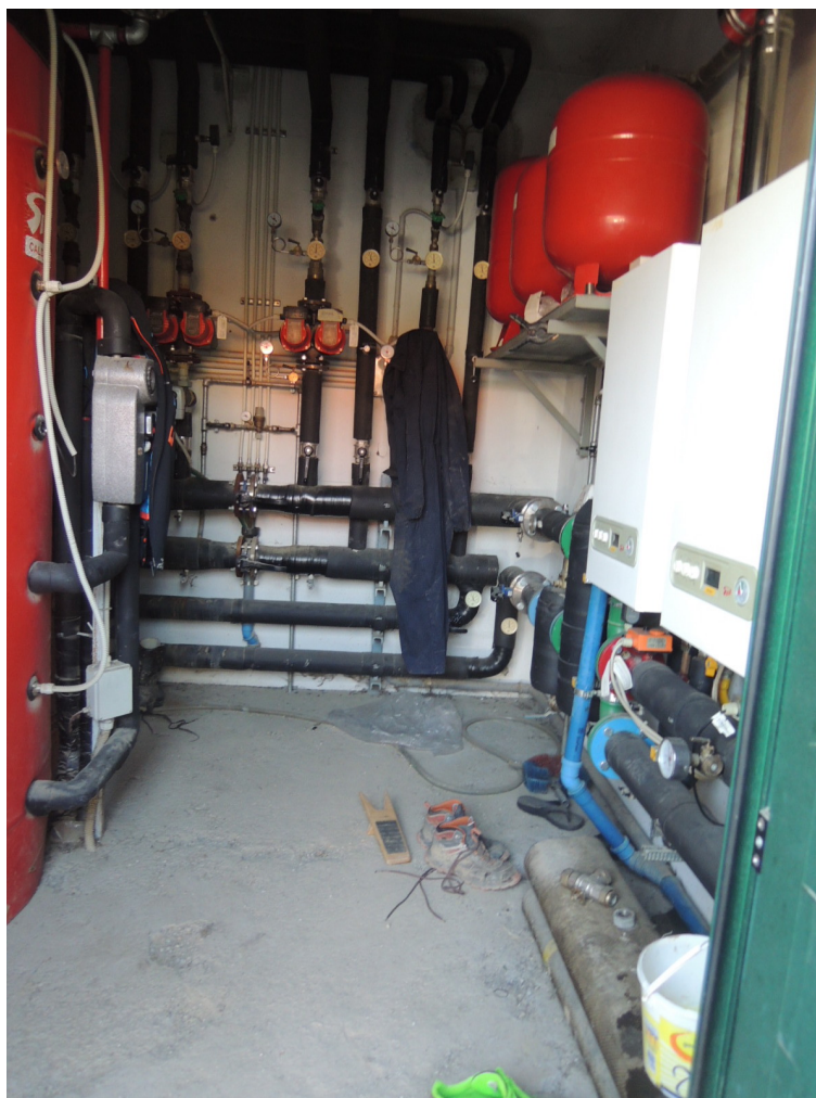
Foto 14 – centrale termica p.t.
