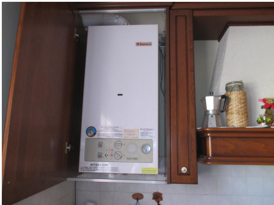
Foto n.14: Particolare della caldaia alimentata a gas metano posta in cucina.
