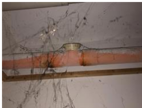
rete fognaria comune a soffitto interna
