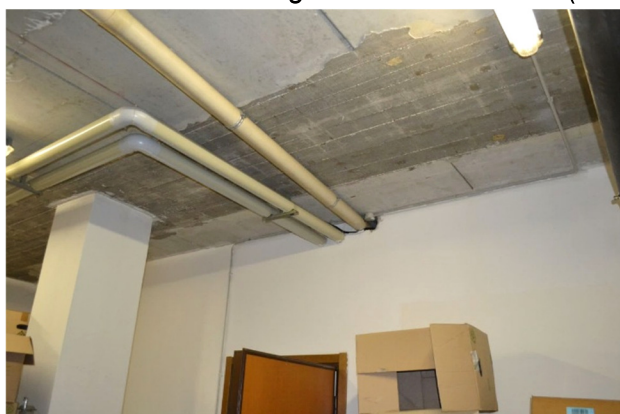
foto 3 - il mantenimento al grezzo delle strutture di soffitto marca visibilmente l'interruzione di continuità dei predalle in corrispondenza della prima trave di spina. Gli alesaggi dei tre tubi grigio chiaro, per il passaggio attraverso il muro sopra l'ingresso, formano degli scassi fuori misura, con tanto di luce passante
