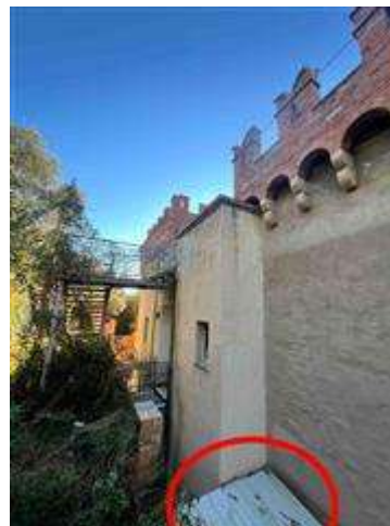
Finale Ligure via Generale Enrico Caviglia 46 Castello di Vuillermis - Fg 40 part 10 Piano -1 Seminterrato - Tettoia abusiva sul retro del fabbricato
