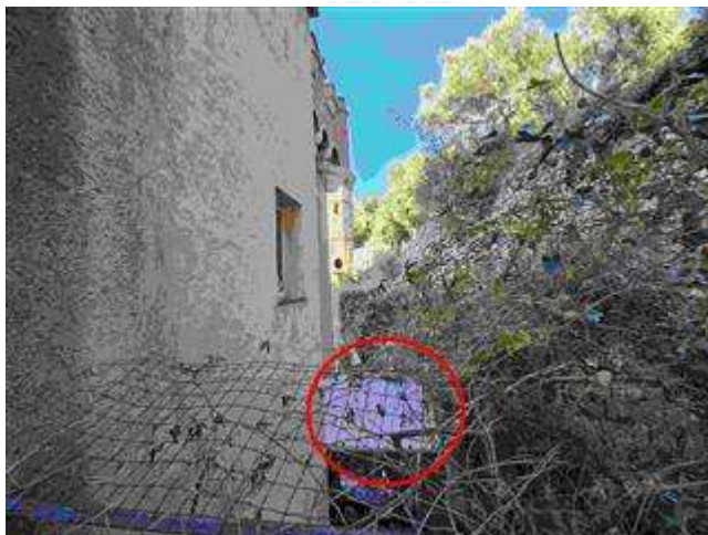
Finale Ligure via Generale Enrico Caviglia 46 Castello di Vuillermis - Fg 40 part 10 Piano -1 Seminterrato - Tettoia abusiva sul retro del fabbricato
