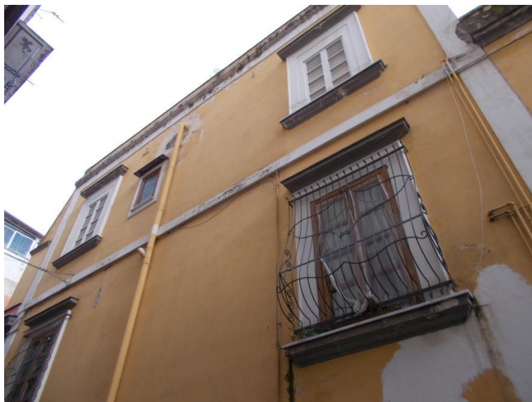
Prospetto su Salita [redacted] presenza di finestre all'ultimo piano che risultano tamponate internamente
