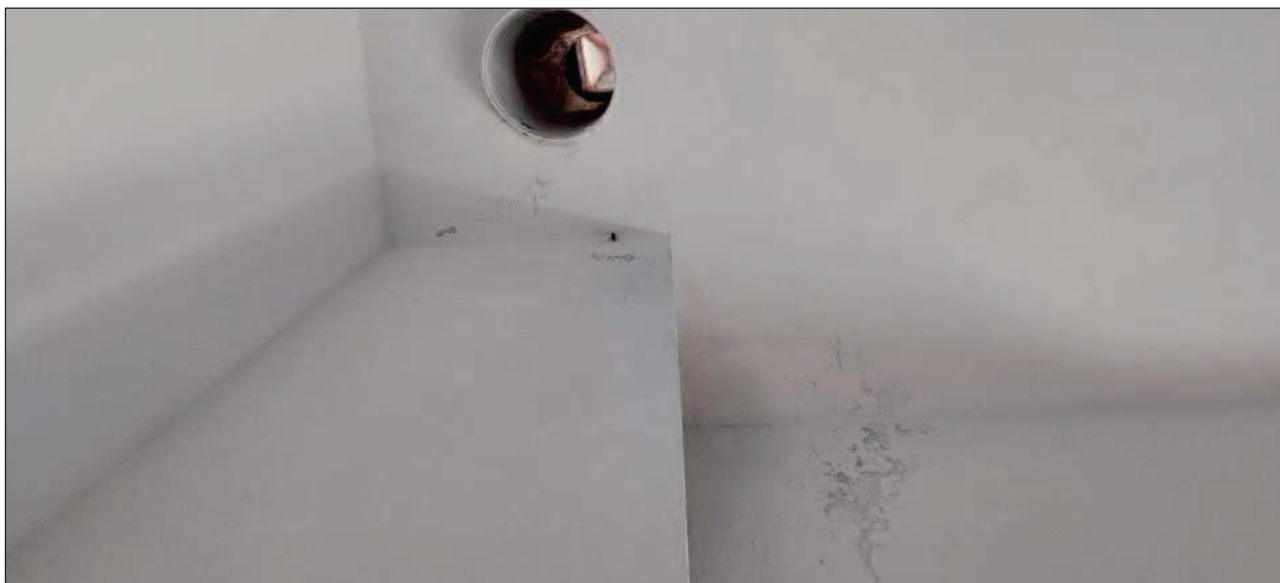
FOTO 7 – predisposizione canna fumaria e particolare delle aree adiacenti interessate da infiltrazioni dalla copertura
