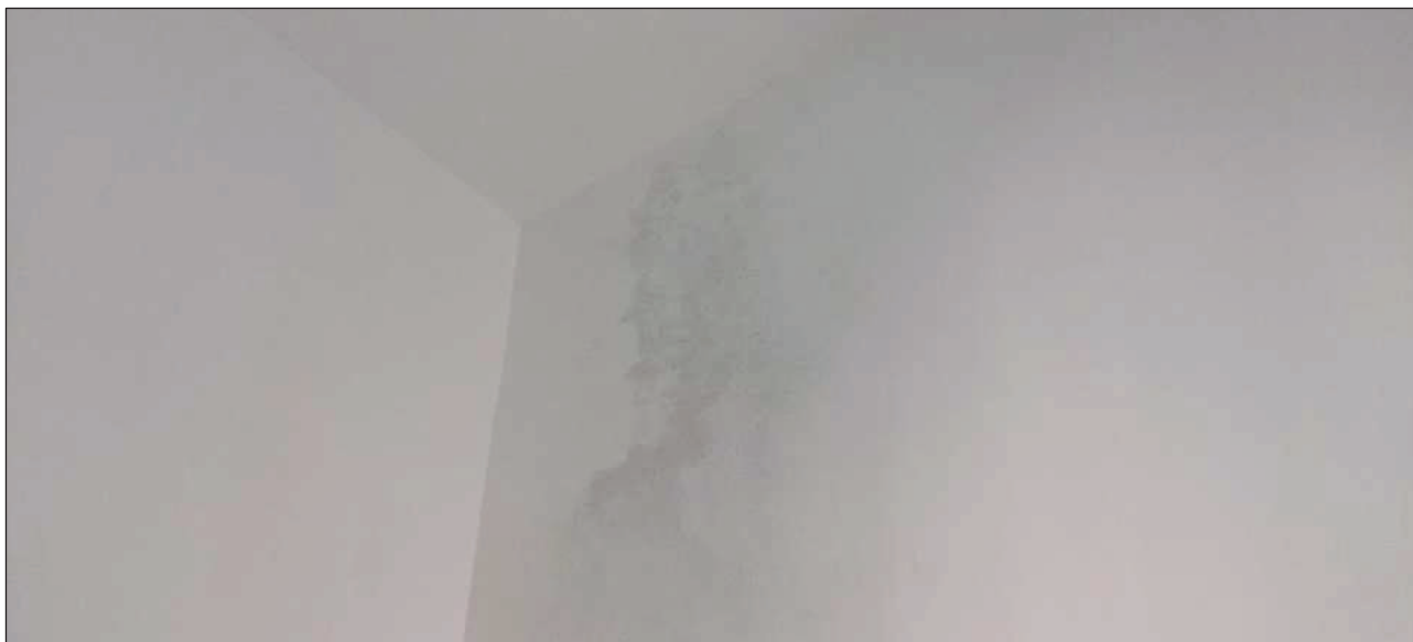
FOTO 12 – particolare della parete di separazione tra camera armadi e servizio igienico interessata da infiltrazioni dalla copertura
