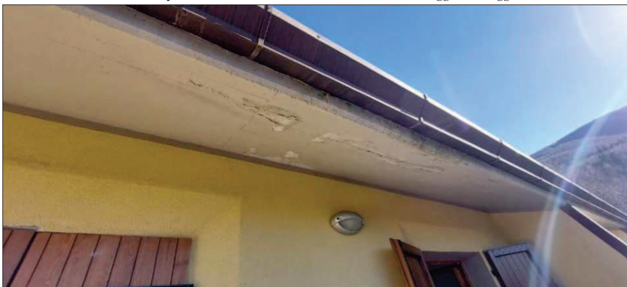
FOTO 27 – particolare della gronda in c.a. con esfoliazione della pitturazione conseguente alle infiltrazioni d'acqua provenienti dalla copertura
