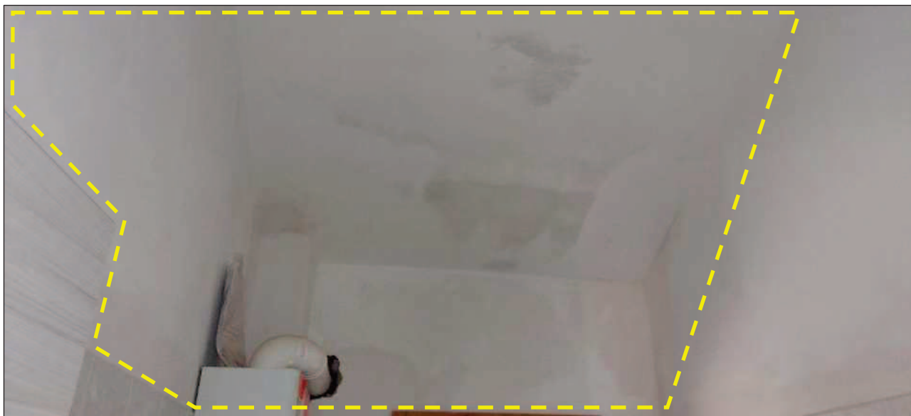
FOTO 18 – soffitto del servizio igienico con individuazione di parte delle aree interessate da infiltrazioni dalla copertura
