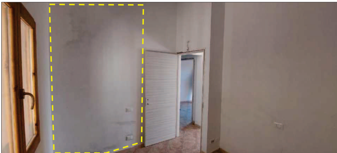
FOTO 10 – camera armadi e relativa parete oggetto di infiltrazioni dalla copertura (cfr. foto 12)
