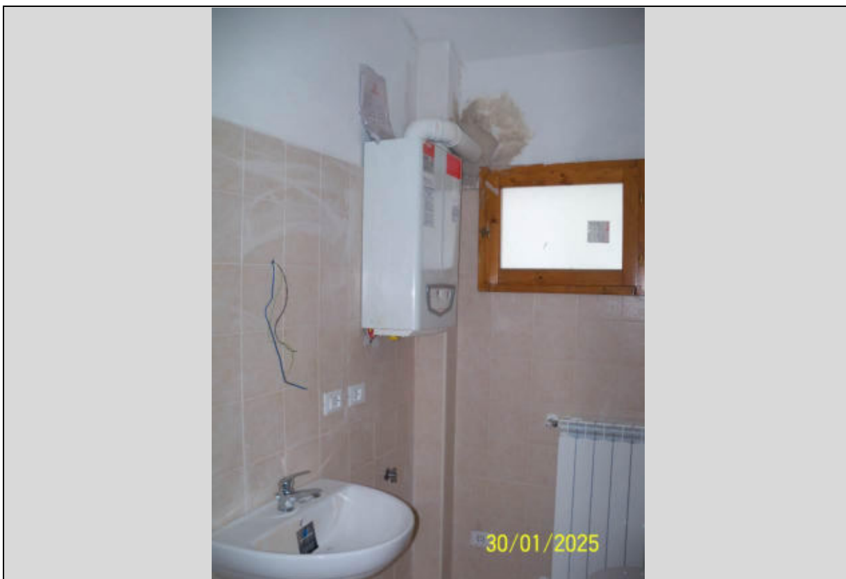
Vista interna: Caldaia murale posta nel bagno
