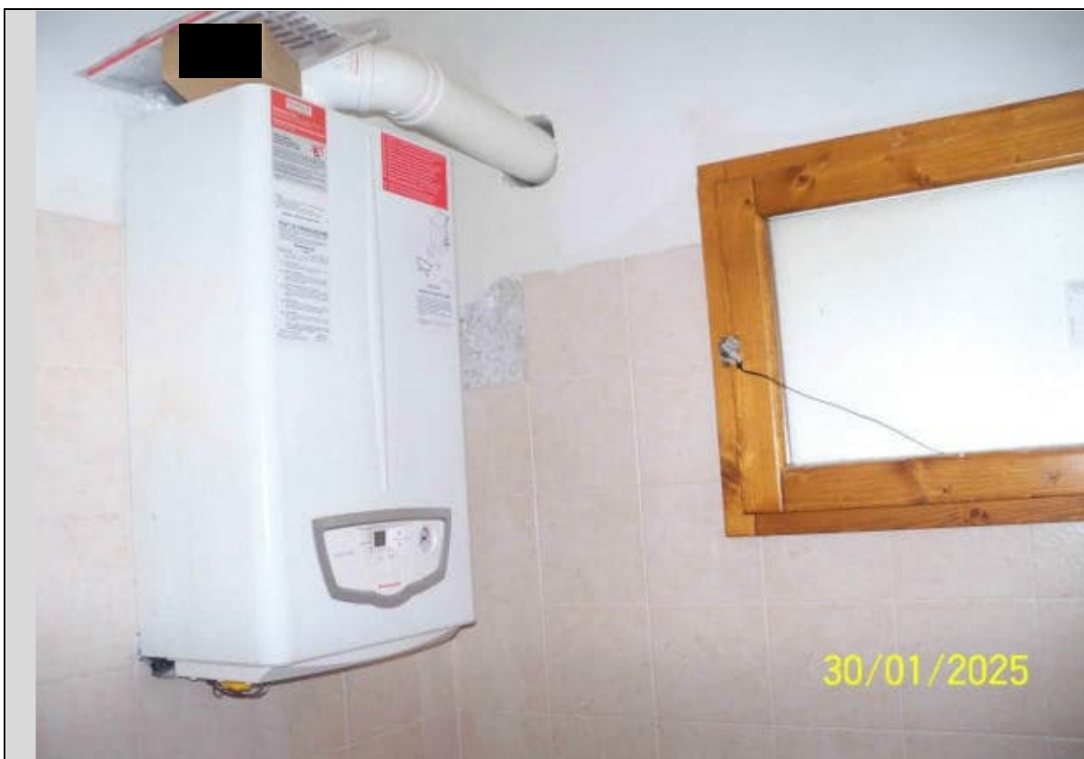
Vista Interna: Caldaia posta nel bagno
