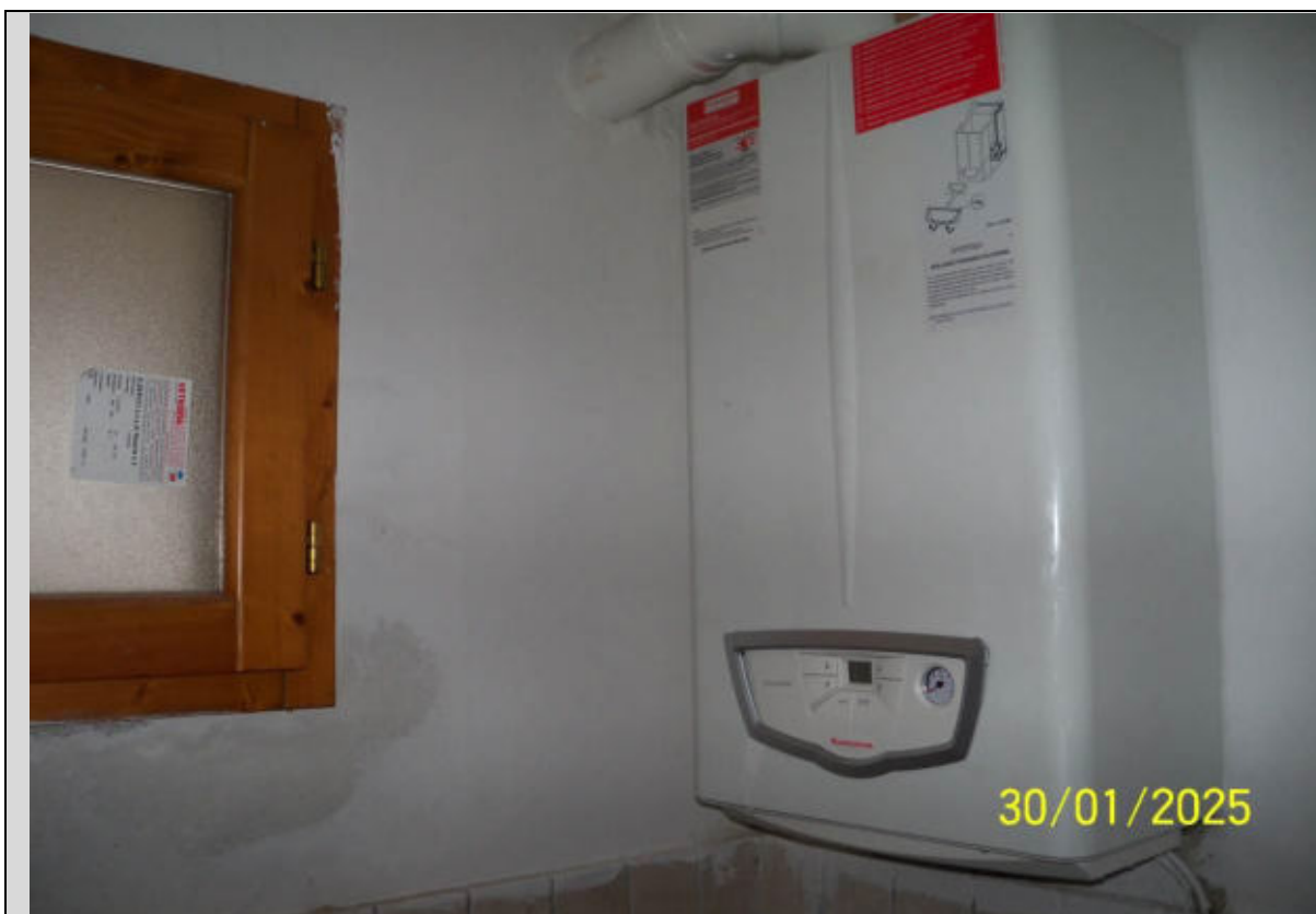
Vista Interna: Caldaia murale posta nel bagno
