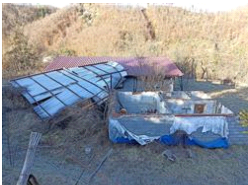
Part. 174: il fabbricato con una parte di tetto divelta e i servizi in stato di avanzato degrado
