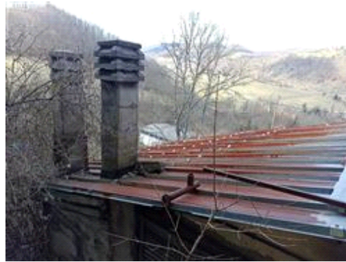
Part. 78, sub. 1: l'ampliamento dei locali con materiali scadenti anche nella copertura
