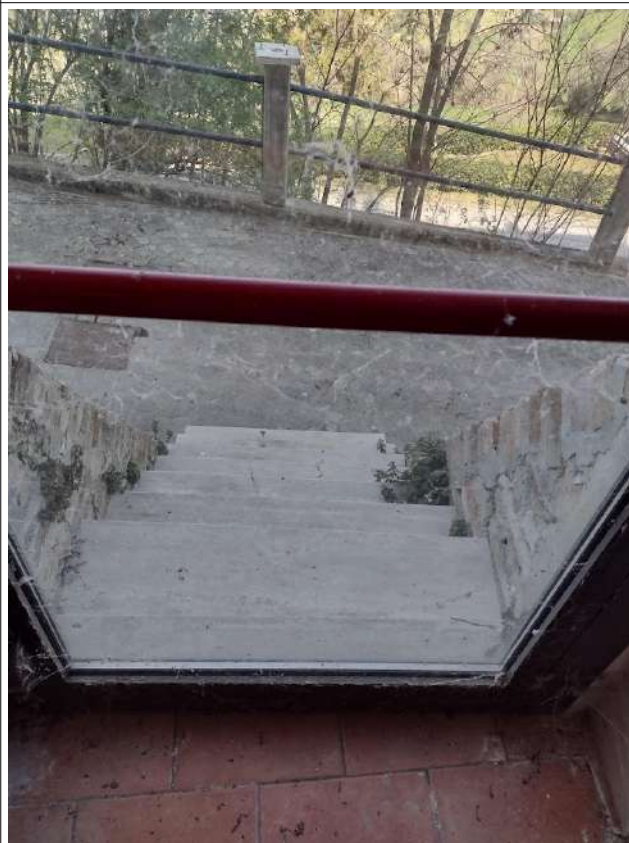
Scaletta uscita di sicurezza su percorso nord mura castellane
