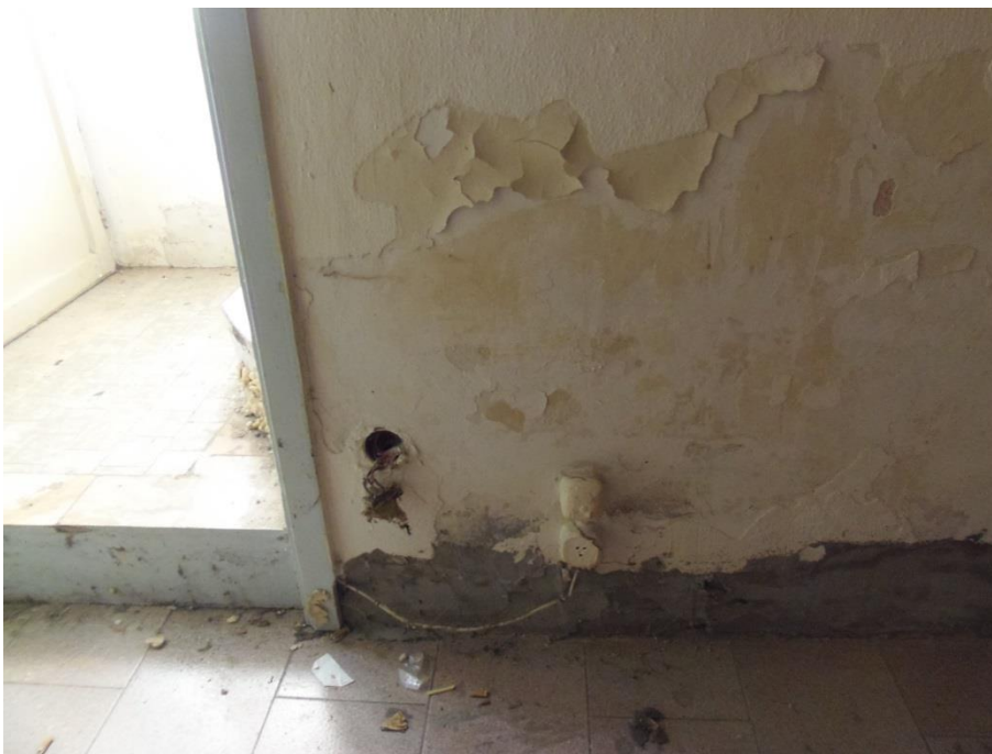
Vista interna (stato manutentivo – crepe, esfoliazioni della tinta e umidità)
