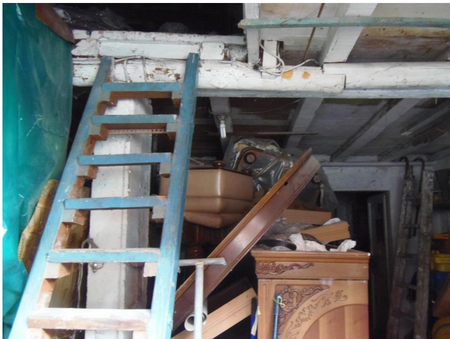
Vista interna del fabbricato ad uso servizi (soppalco realizzato senza titolo autorizzativo)
