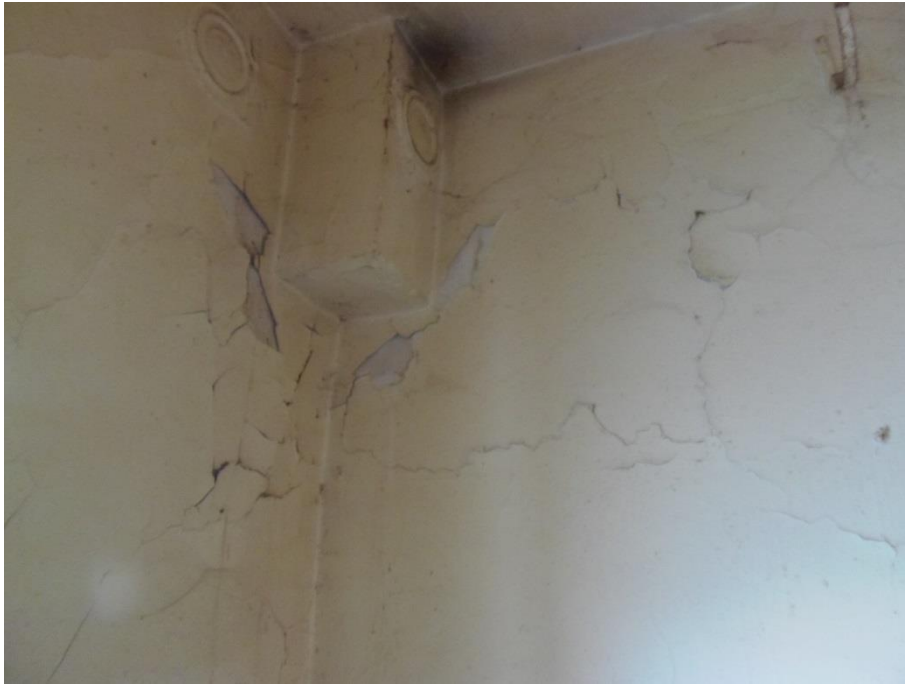
Vista interna (stato manutentivo – crepe, esfoliazioni della tinta e umidità)
