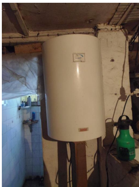
Vista interna del fabbricato ad uso servizi (boiler all'interno del w.c. realizzato senza titolo autorizzativo)
