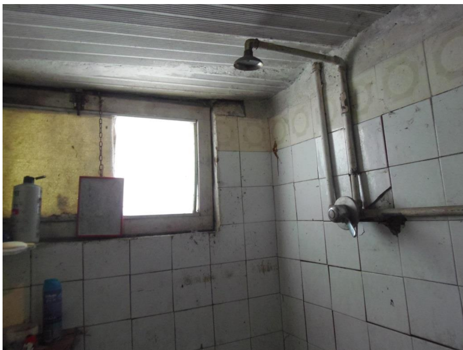
Vista interna del fabbricato ad uso servizi (w.c. realizzato senza titolo autorizzativo)
