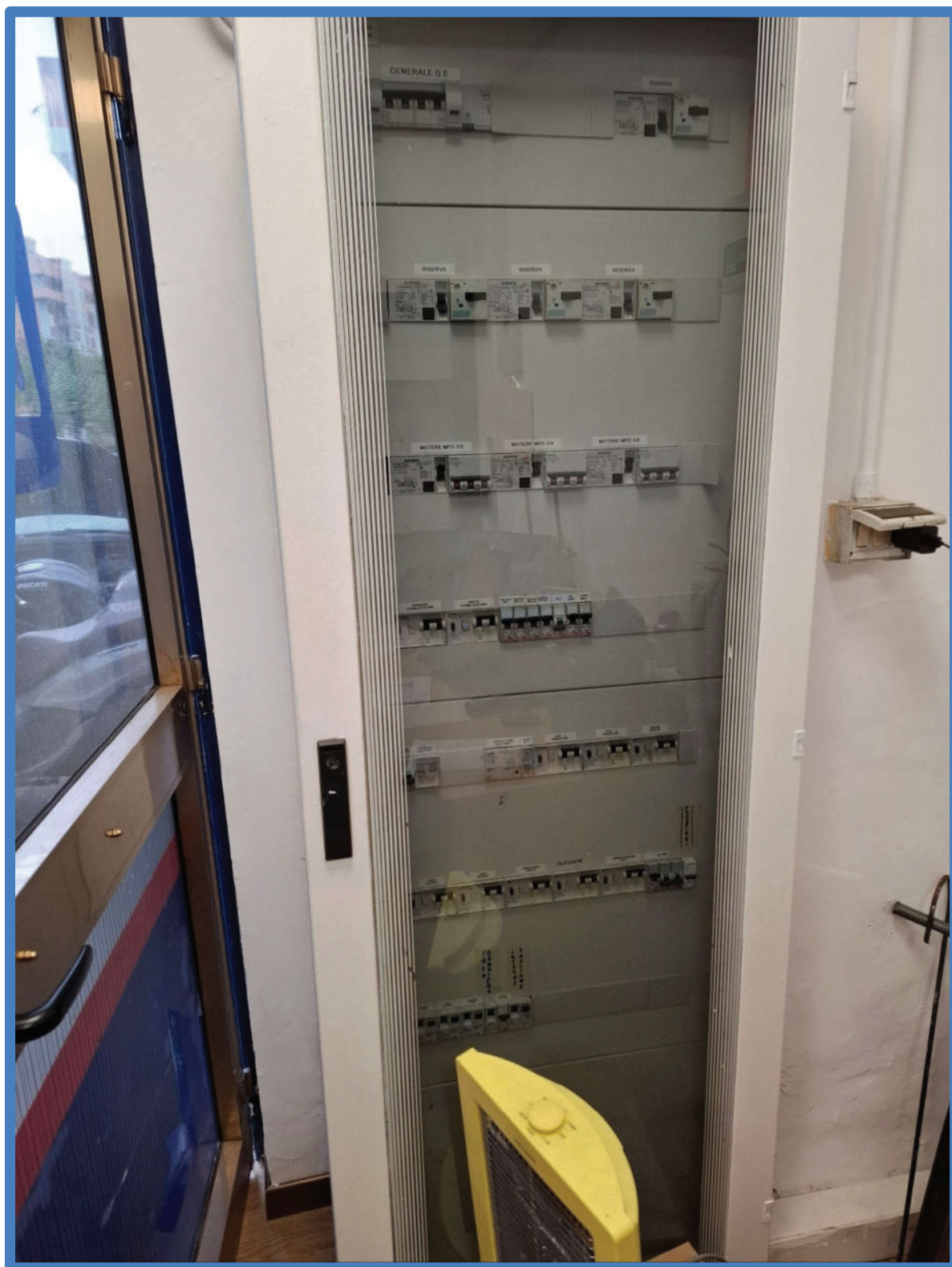
Documento fotografico 20 – LOTTO 2 - Quadro elettrico
