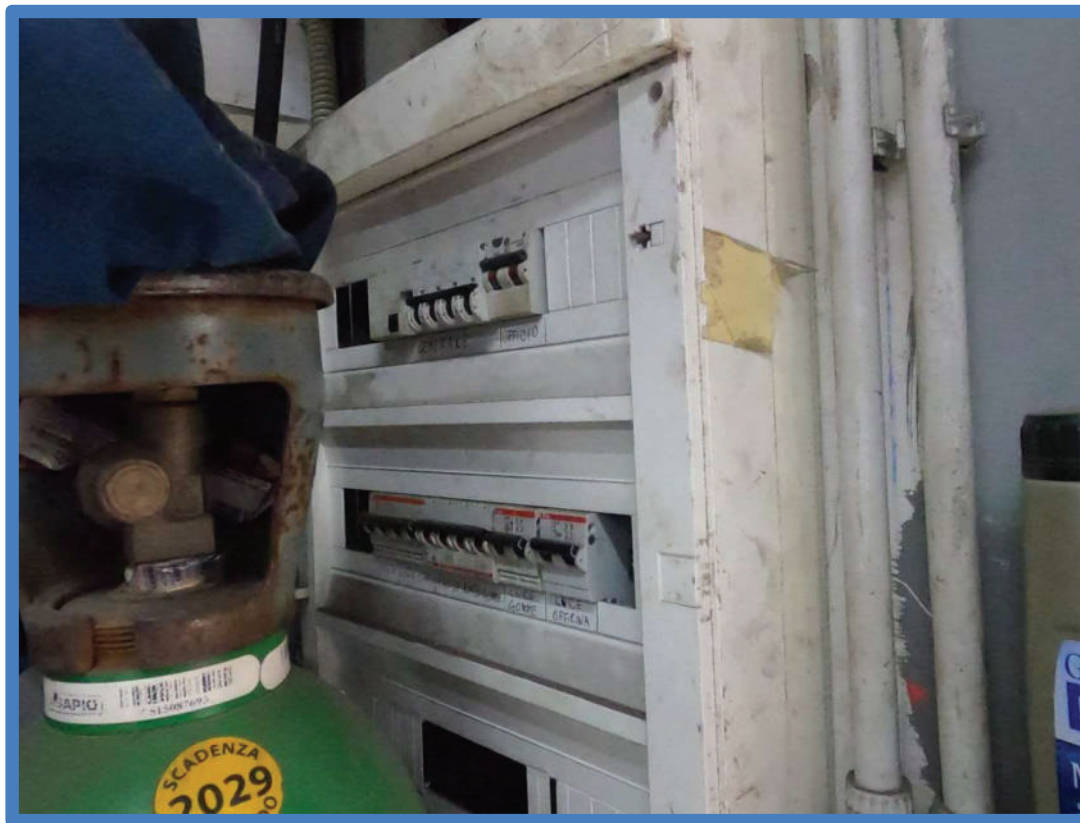
Documento fotografico 15 – LOTTO 1 - Quadro elettrico generale dell'officina
