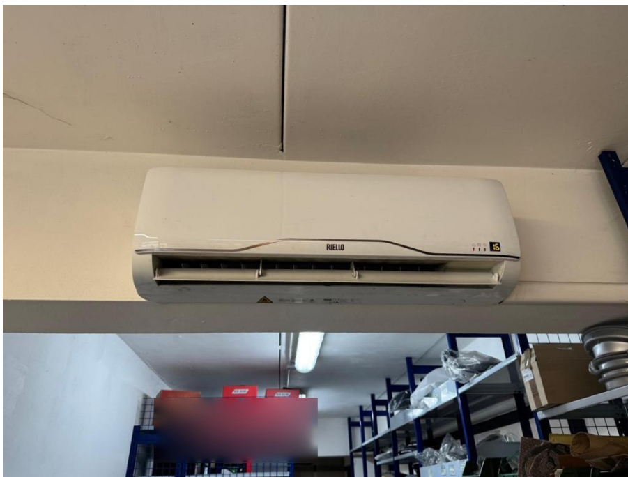
11. – Vista interna: negozio (imp. riscaldamento)
