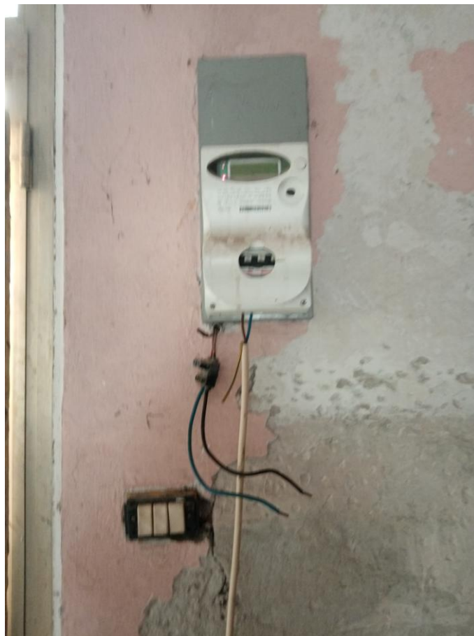
Foto 23_ particolare dello stato fatiscente degli impianti
