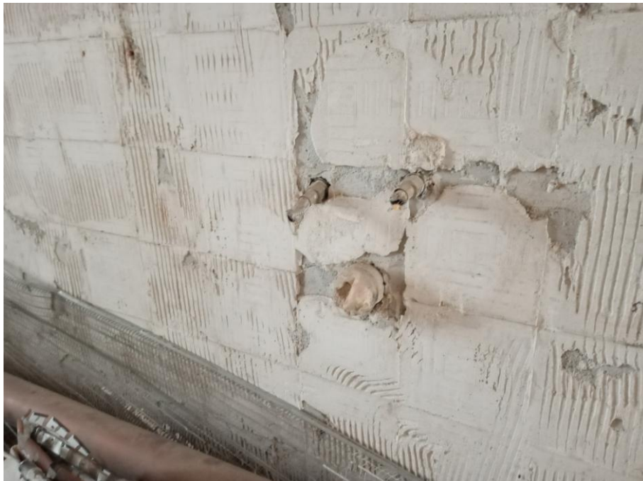
Foto 25_ particolare dello stato fatiscente degli impianti
