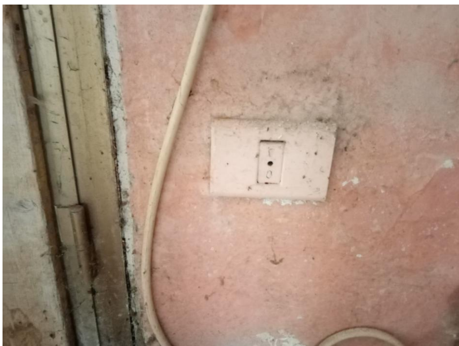
Foto 24_ particolare dello stato fatiscente degli impianti
