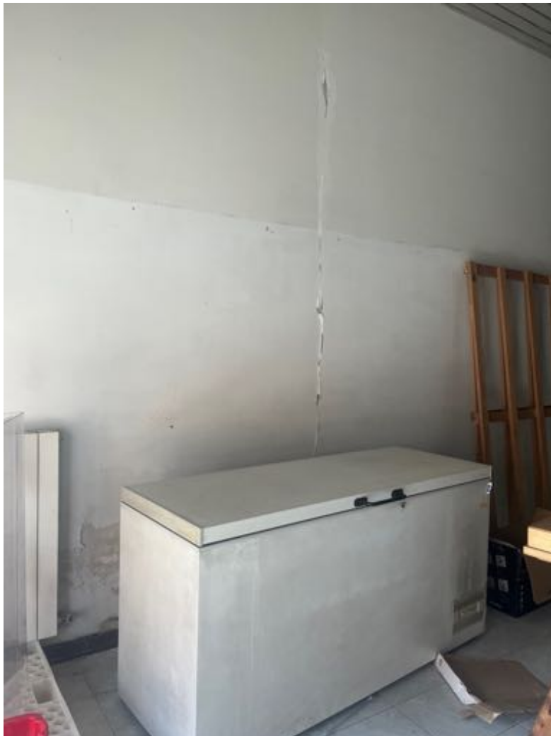
Vista della parete verso il sottoscala dove sono presenti crepa verticale ed umidità di risalita.
