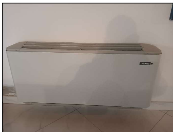
Foto 30 – Unità interna di climatizzazione
