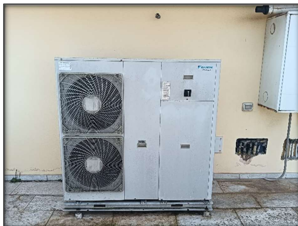
Foto 12 – Particolare chiller climatizzazione
