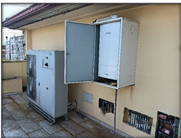
Foto 13 – Particolare chiller e scaldacqua a gas
