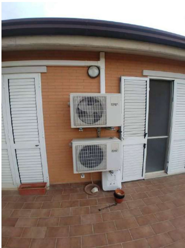
Figura 35 : Piano sottotetto (motori a servizio dei climatizzatori)
