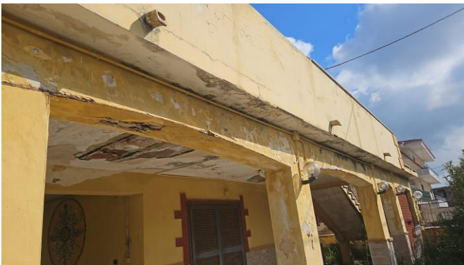
Porticato al P.T - sfondellamento del solaio
