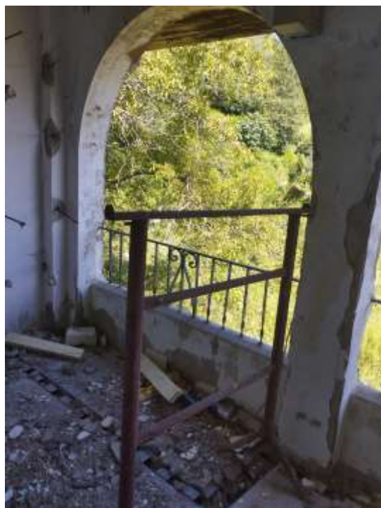
Terrazzo coperto PIANO SECONDO ( non rientra nella Procedura ma è situato al di sopra del soffitto crollato)
