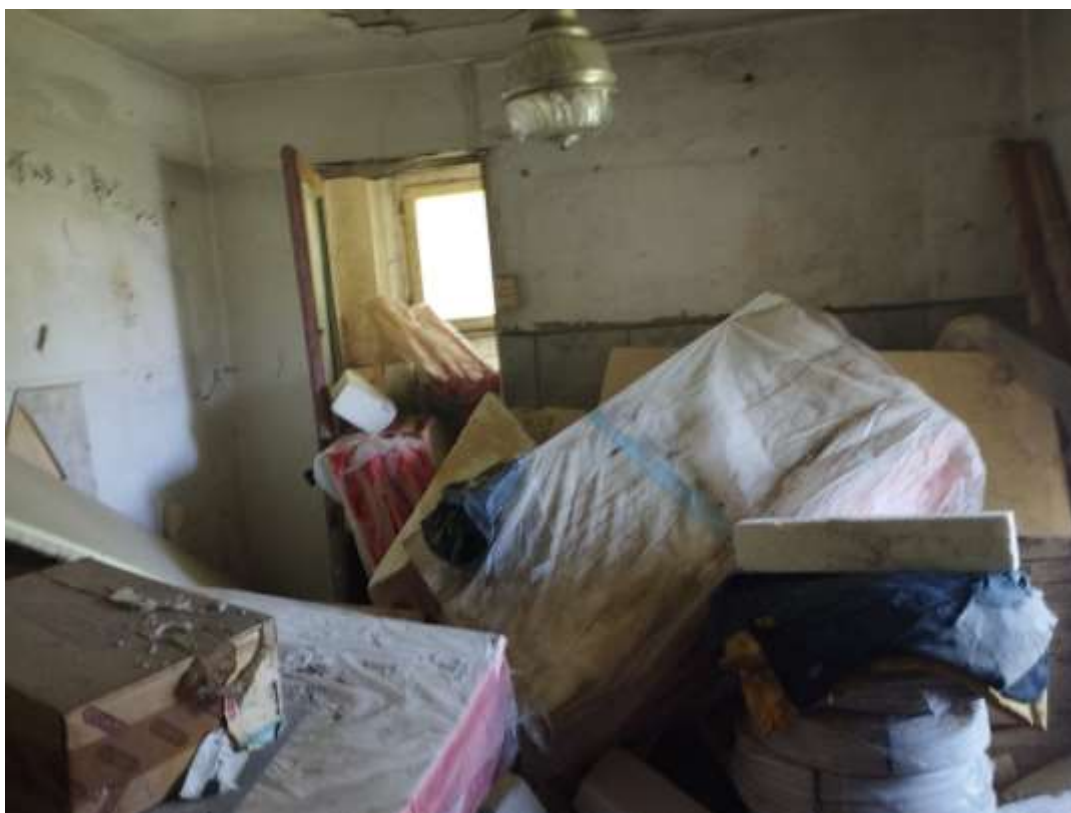
SOGGIORNO PIANO SECONDO ( non rientra nella Procedura ma le solette sono eccessivamente caricate)
