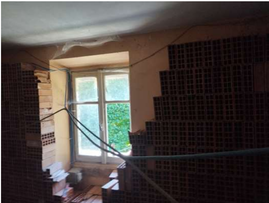
CAMERA PIANO SECONDO ( non rientra nella Procedura ma le solette sono eccessivamente caricate)
