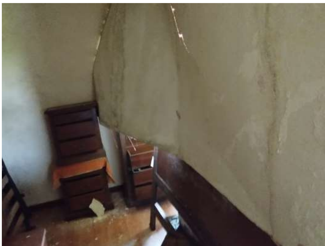
(Soffitto crollato) CAMERA LETTO PIANO PRIMO SUB 1
