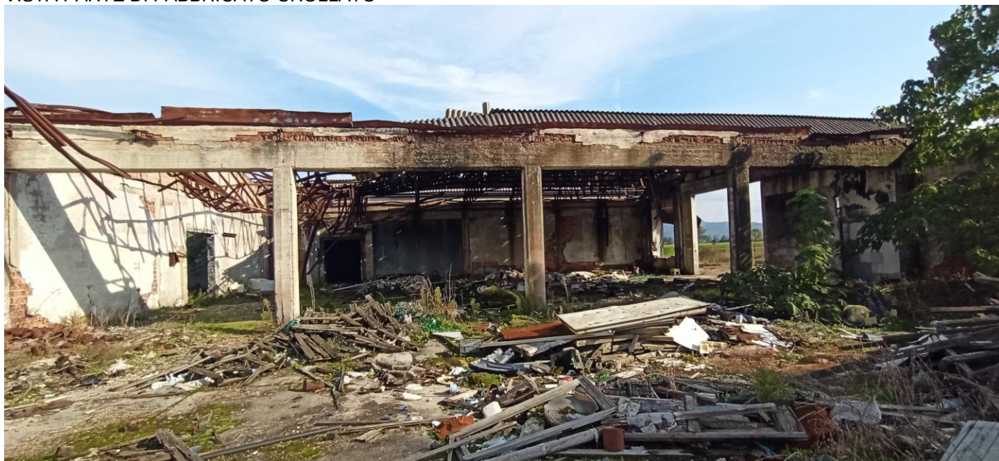
VISTA PARTE DI FABBRICATO CROLLATO
