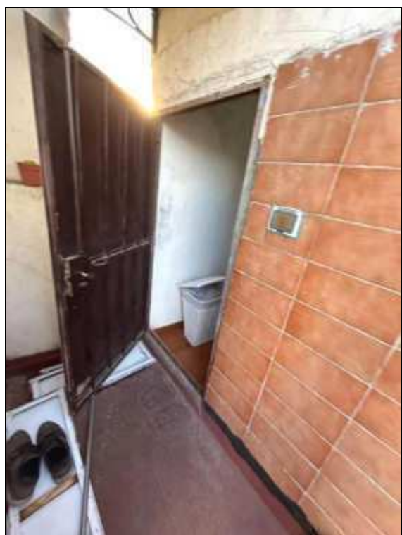
Foto 23/24 - soggiorno/ terrazza - p. secondo - stato tipologico e conservativo
