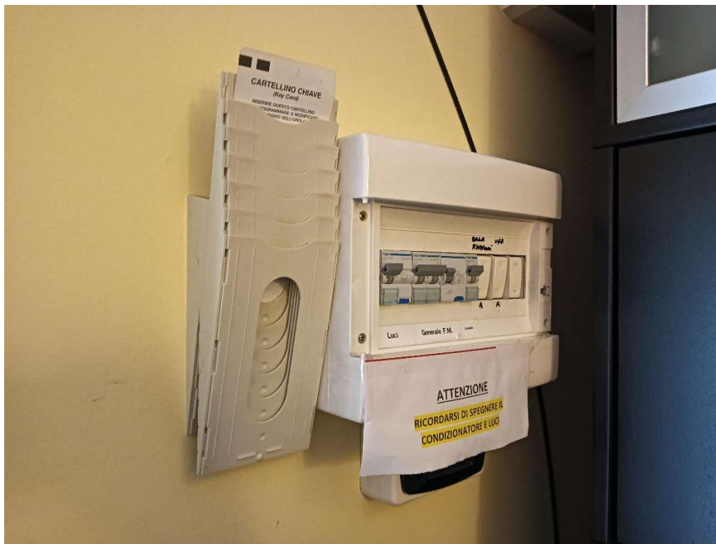
Vista del quadro elettrico generale
