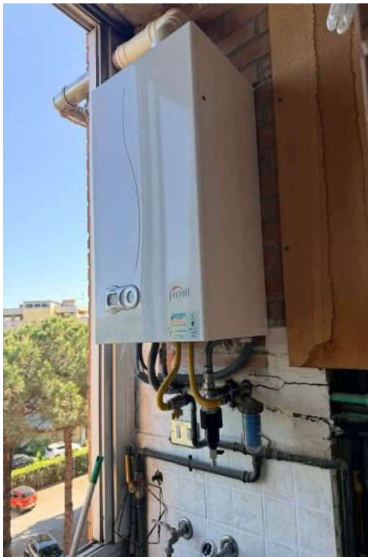
Figura 9: Vista interna, caldaia in veranda BENE 1
