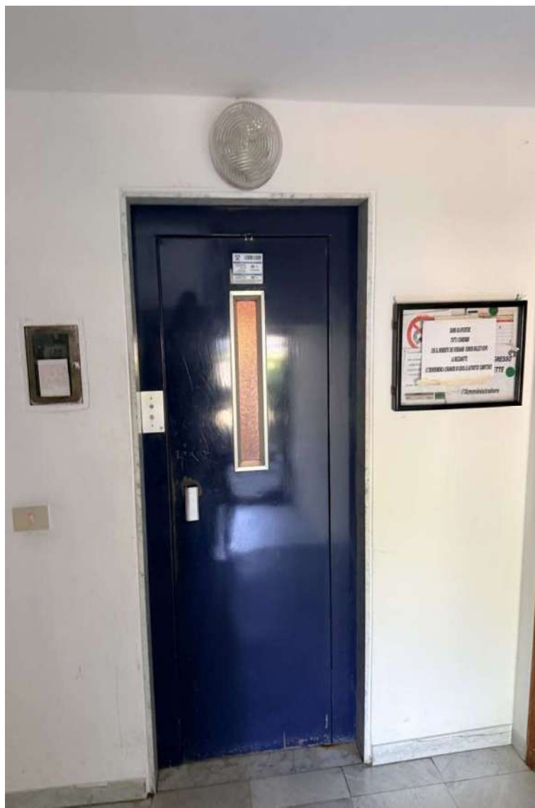
Figura 3: Vista interna, ascensore
