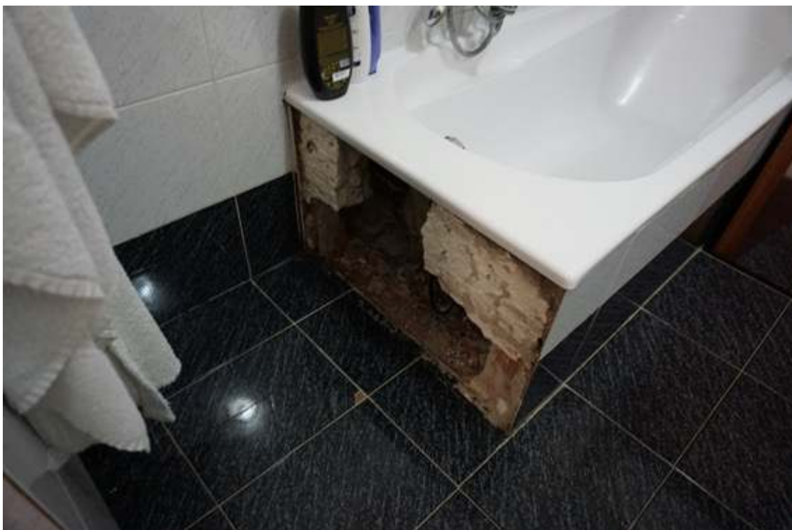
Fig.13 – Vista dell’ammaloramento della vasca da bagno
