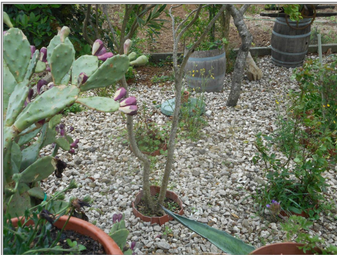
FOTO 21 – Particella 1035 sub 3 (Abitazione) : il bombolone di gpl interrato, ubicato nell'adiacente spazio a giardino
