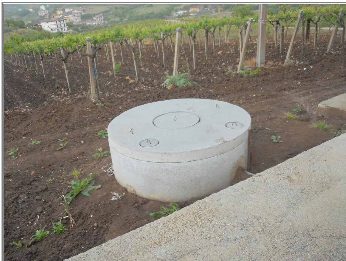
FOTO 20 – una delle due fosse biologiche ubicate a valle del prospetto laterale dx
