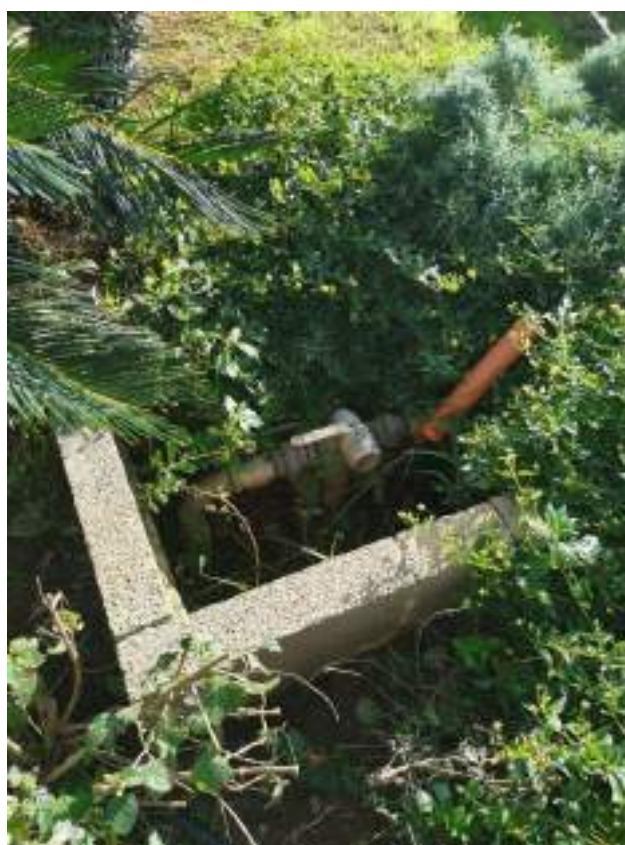
Figura 21: Pozzo Artesiano presente nella struttura
