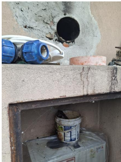
CALDAIA CON MANCANZA COLLEGAMENTO CANNA FUMARIA
