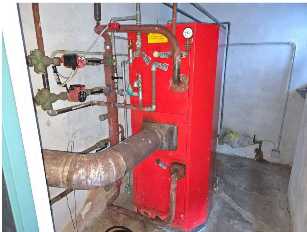
Foto n. 18 : C.F. Fg. 38 mapp. 72 - Locale caldaia comune
