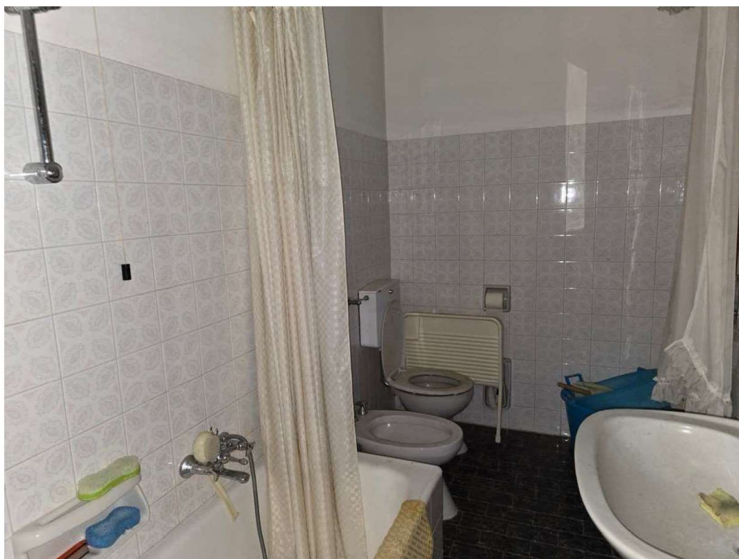
Foto n. 15 : C.F. Fg. 38 mapp. 72 sub 3 - Piano secondo, bagno
