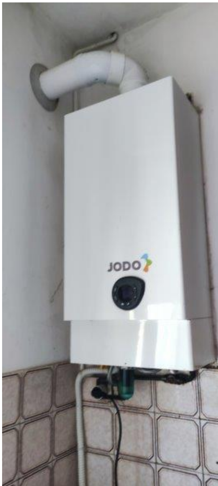
Figura 14 Caldaia Fabbriato n°4
