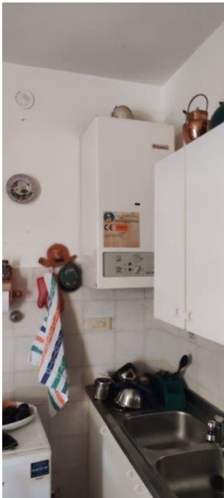
Figura 16 Caldaia Fabbri n°3
