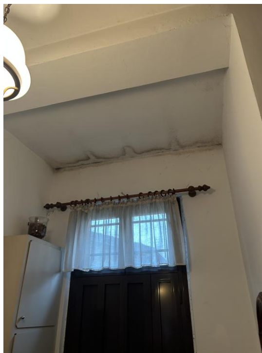
Foto 8 – tracce di umidità in corrispondenza della soletta sopra l'ingresso
