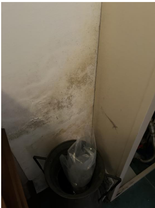
Foto 9 – tracce di umidità alla base delle pareti dell'ingresso
