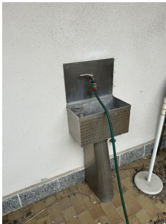
Foto 30: punto acqua esterno
