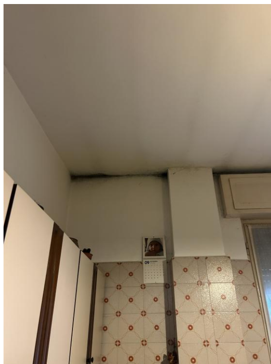
Foto 20 - cucina tracce di umidità in prossimità delle pareti perimetrali
