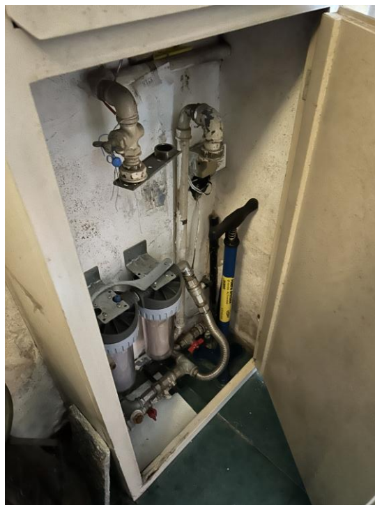
Foto 10 – assenza di contatore del gas
