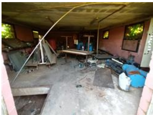
Locale pompe con evidenza stato abbandono
