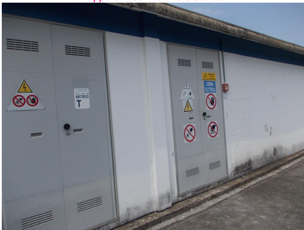
mappale 1089 - cabina elettrica -
