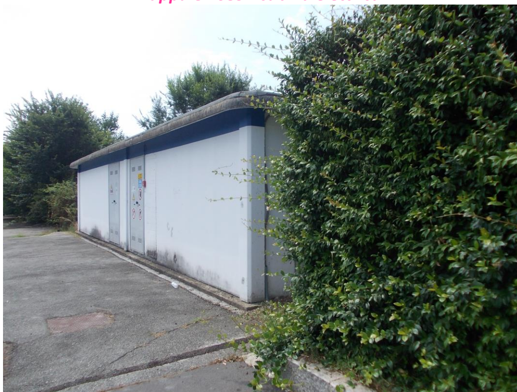
mappale 1089 - cabina elettrica -
