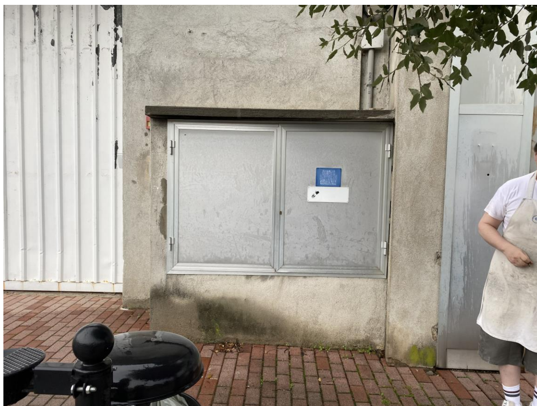
SEDE CONTATORI ELETTRICI
