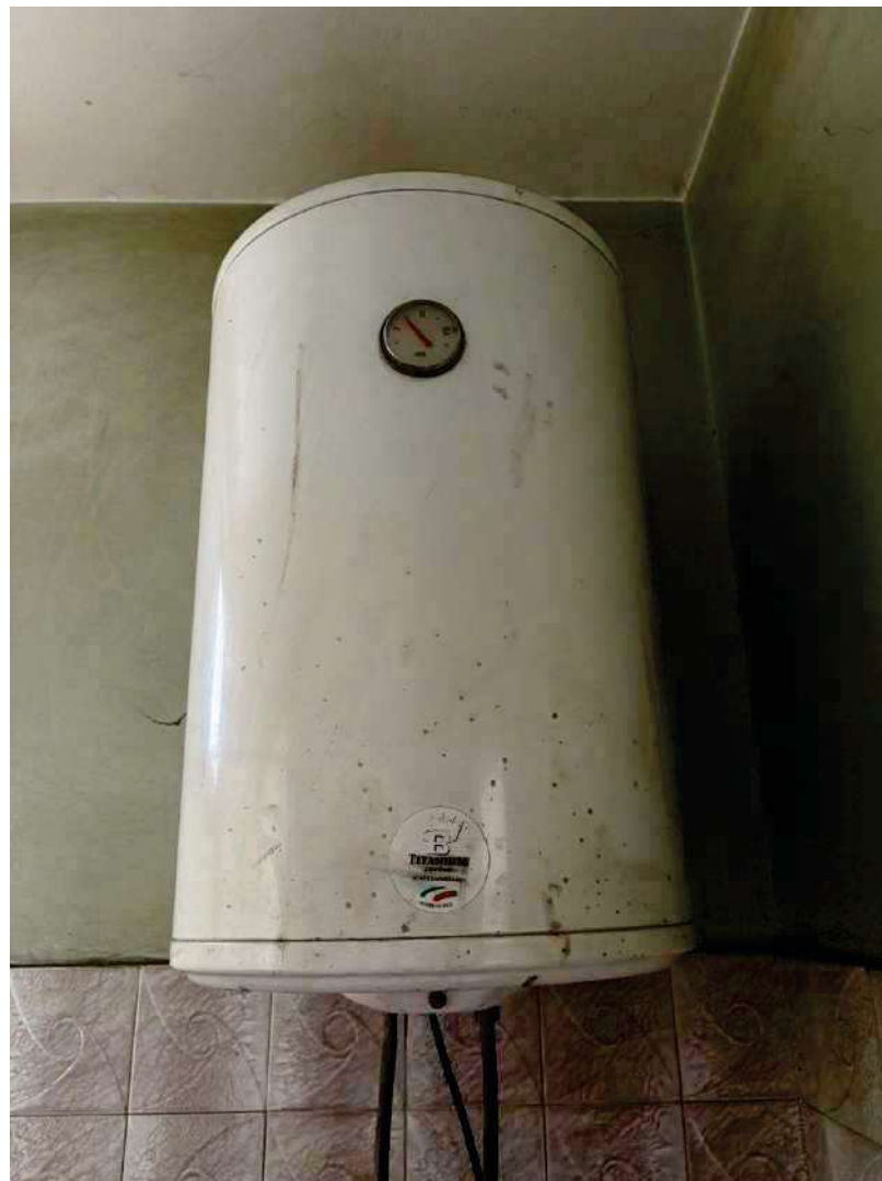
INTERNO CAPANNONE N.1 – BAGNO A SERVIZIO DEGLI OPERAI BOILER DI ACCUMULO ACQUA CALDA SANITARIA
