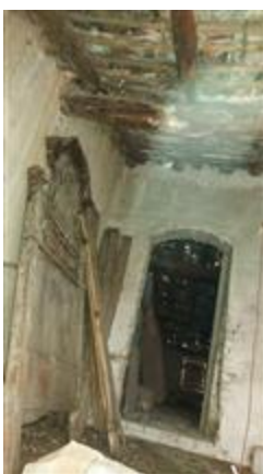
un deposito al piano primo
