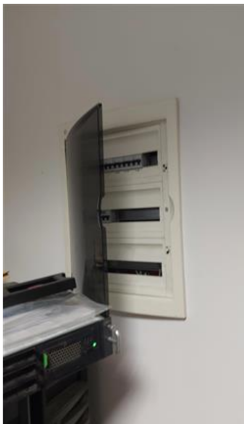
Il quadro elettrico
