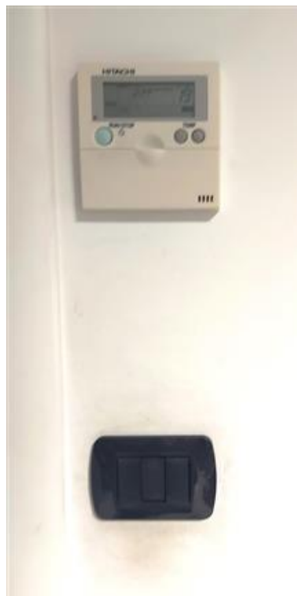
il termostato e gli interruttori della luce
