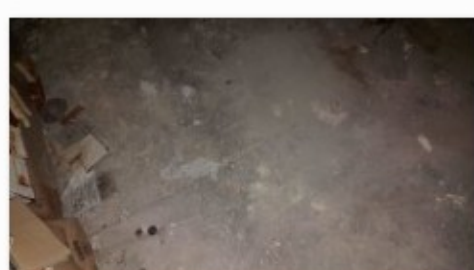
depositi pavimento 1.jpg
