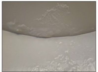
FOTO 114 - INFILTRAZIONE SOFFITTO E PARETE PIANO SECONDO
