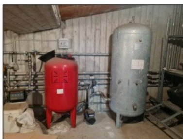
FOTO 44 - IMPIANTI VANO SOTTO RAMPA CARRABILE
