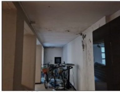
FOTO 109 - INFILTRAZIONE A PIANO INTERRATO
