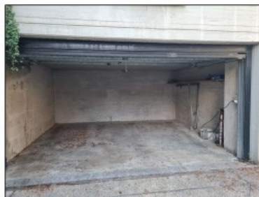
FOTO 21 - AUTORIMESSA NON CONFORME
