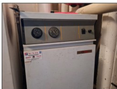
FOTO 97 - CALDAIA TRADIZIONALE MARCA RIELLO
