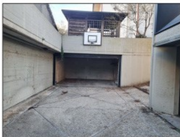
FOTO 20 - AUTORIMESSA NON CONFORME
