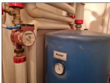
FOTO 103 - ACCUMULO ACQUA CALDA SANITARIA
