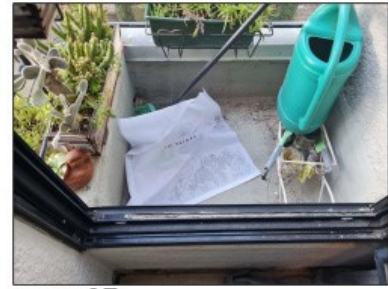
FOTO 27 - VERANDA NON CONFORME
