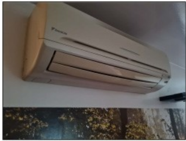
FOTO 100 - SPLIT RAFFRESCAMENTO INTERNO MARCA DAIKIN
