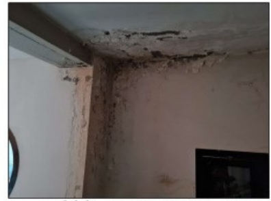
FOTO 111 - INFILTRAZIONE A PIANO INTERRATO
