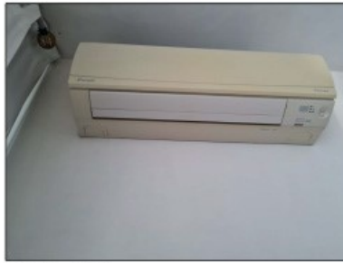
FOTO 101 - SPLIT RAFFRESCAMENTO INTERNO MARCA DAIKIN
