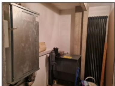
FOTO 94 - SALA MACCHINE ASCENSORE
