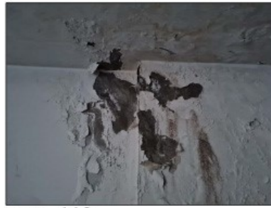
FOTO 110 - INFILTRAZIONE A PIANO INTERRATO
