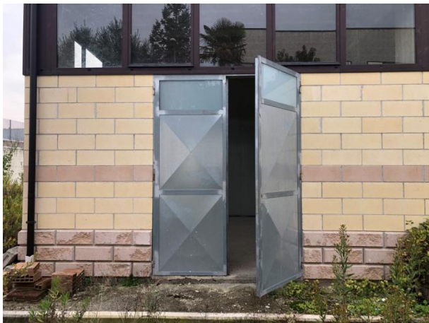
5 Particolare accesso vano terra
