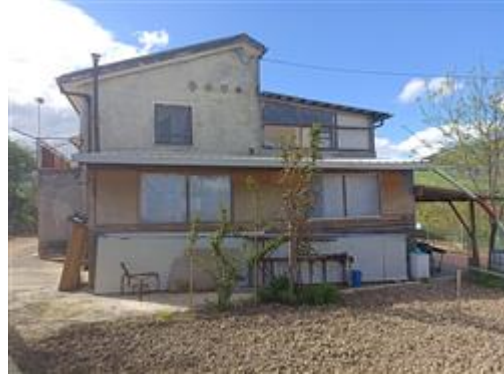
Part. 91, sub. 1. La facciata orientale, caratterizzata da ampliamenti non regolari, con materiali scadenti
