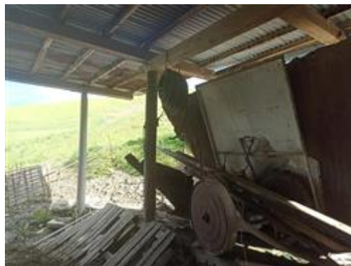
Part. 220. La tettoia realizzata a monte, non presente nella planimetrie (Prat. Ed. n. 209/86); interno
