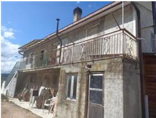
Part. 91, sub. 1. Il terrazzo con funzione di ballatoio, per l'accesso alla porzione posta al piano primo; sono evidenti i segni di deterioramento dell'intonaco
