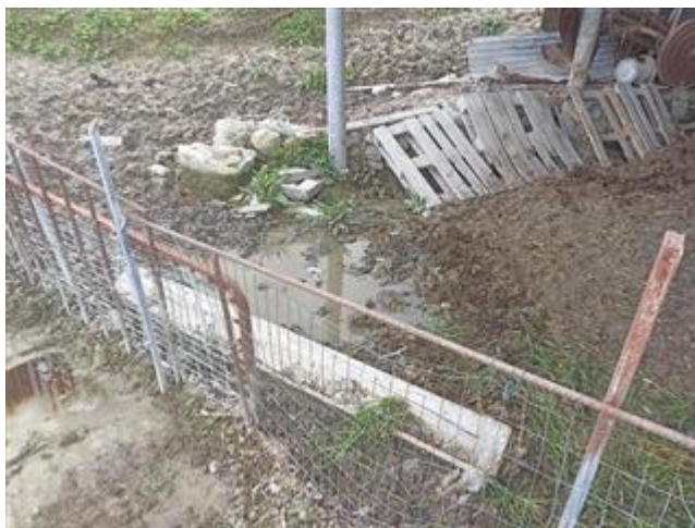
Part. 220. L'accumulo d'acqua, presumibilmente legato all'evento franoso segnalato (2025)
