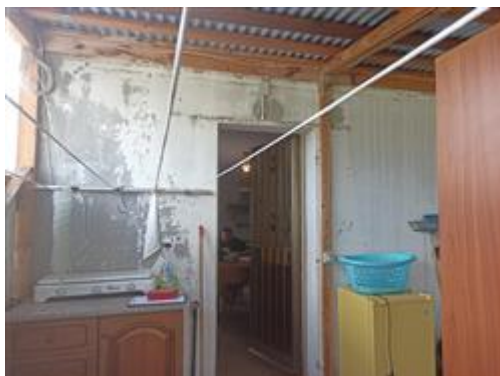
Part. 91, sub. 1. Piano primo: la veranda, realizzata in tempi recenti, sullo spazio del terrazzo; i materiali sono molto scadenti
