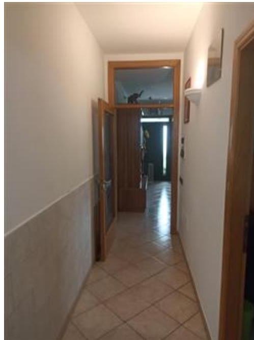
Part. 91, sub. 2. Il disimpegno, con rivestimento anche nella parete per contenere l'umidità di risalita
