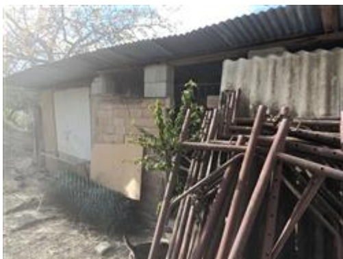
Part. 221 (deposito, pollaio, porcilaia), esterno; il materiale da costruzione è scadente
