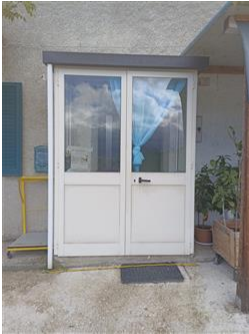
Part. 91, sub. 2. La veranda a protezione del portoncino d'ingresso, realizzata con materiale inadeguato, non presente in nessuna planimetria
