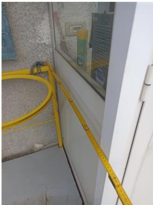
Part. 91, sub. 2. La veranda a protezione del portoncino d'ingresso, realizzata con materiale inadeguato, non presente in nessuna planimetria; particolare
