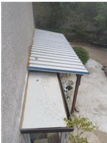
Part. 91, sub. 1 e 2. I manufatti a protezione degli ingressi, realizzati con materiali non adeguati, non rappresentati in nessuna planimetria
