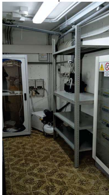
Foto locale impianti PS1
