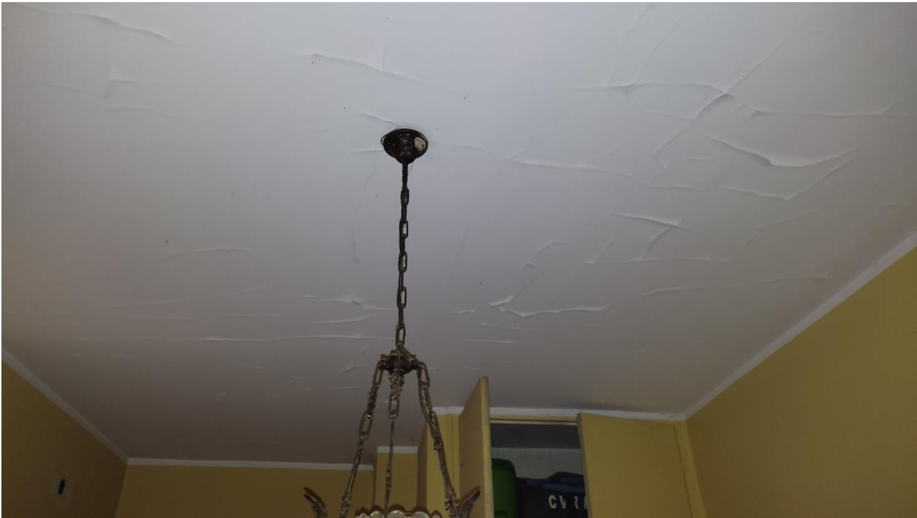
Foto dettaglio esfoliazione tinte del soffitto:
