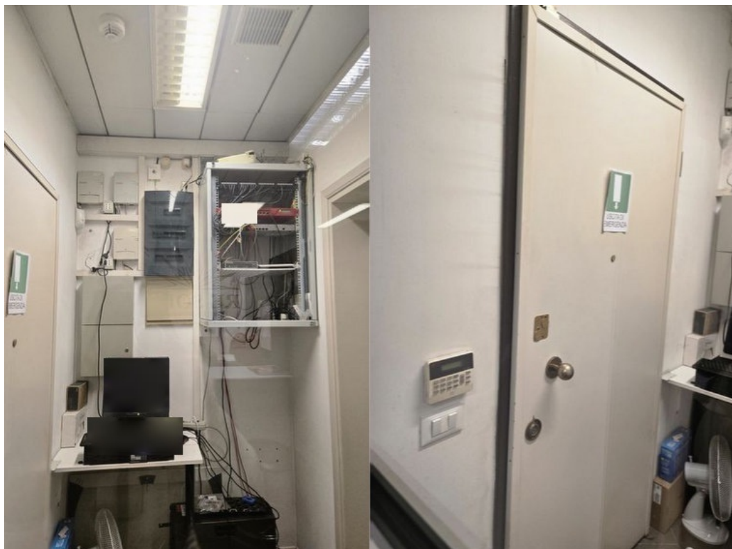
Fig.7-Ingresso; Porta blindata-pannello interno laccato di accesso all'ufficio;
